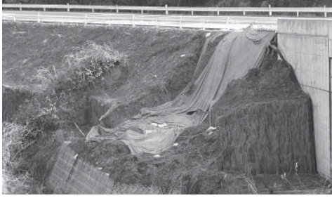
広域農道の被災箇所
