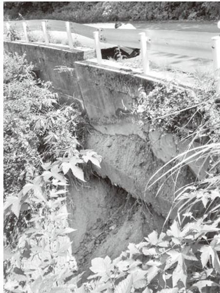
林道高津線の被災箇所
