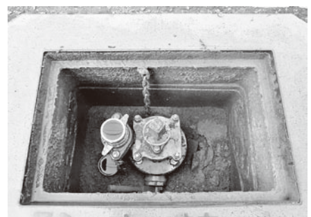
漏水した消火栓を修繕
