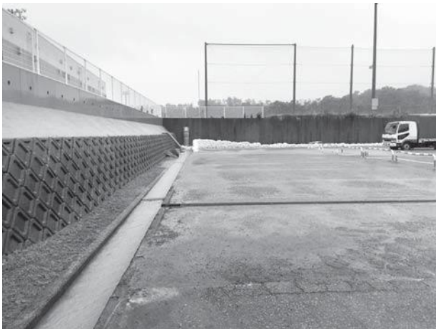
(大雨時に溢れる中学校の排水路)
