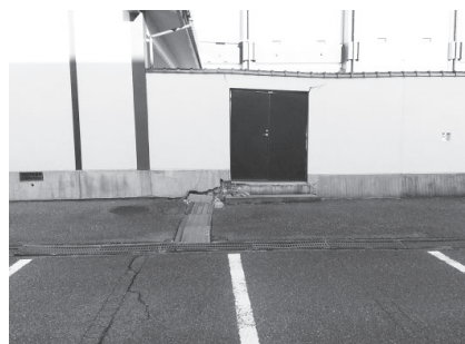
被災した武道館弓道場
