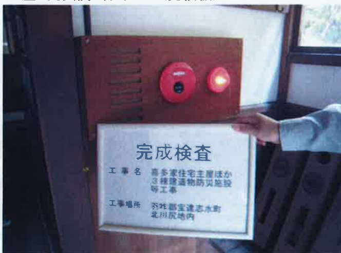
主屋 内玄関 非常ベル(発信機)
