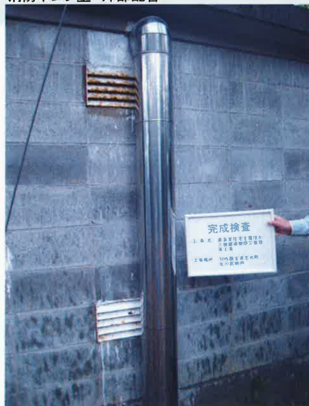
消防ポンプ室 外部配管
