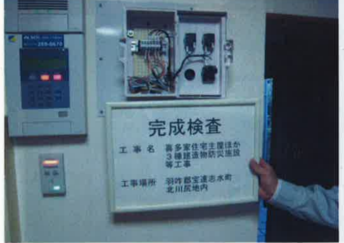
消防ポンプ 遠隔操作盤
