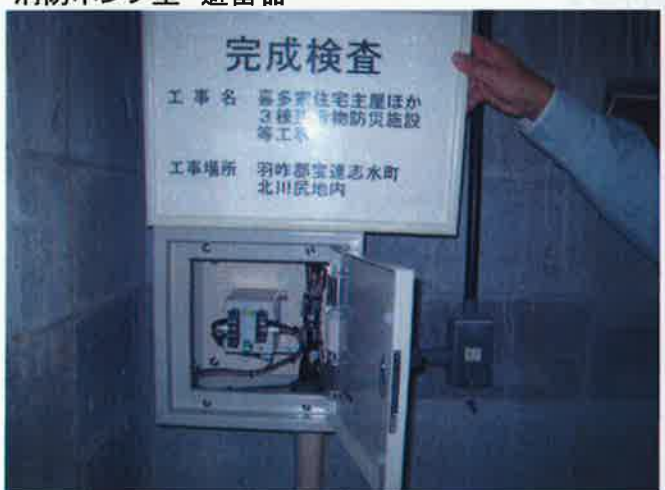
消防ポンプ室 避雷器
