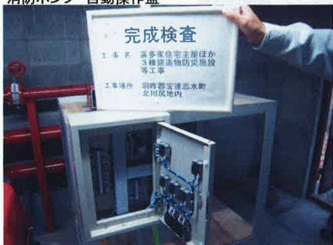
消防ポンプ 自動操作盤
