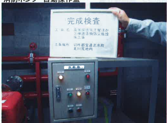
消防ポンプ 自動操作盤
