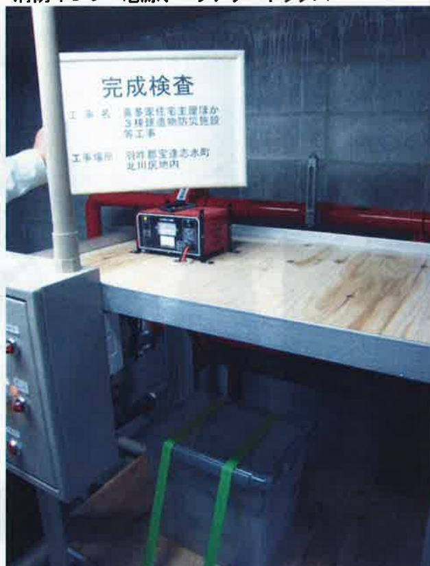
消防ポンプ 電源、バッテリーボックス
