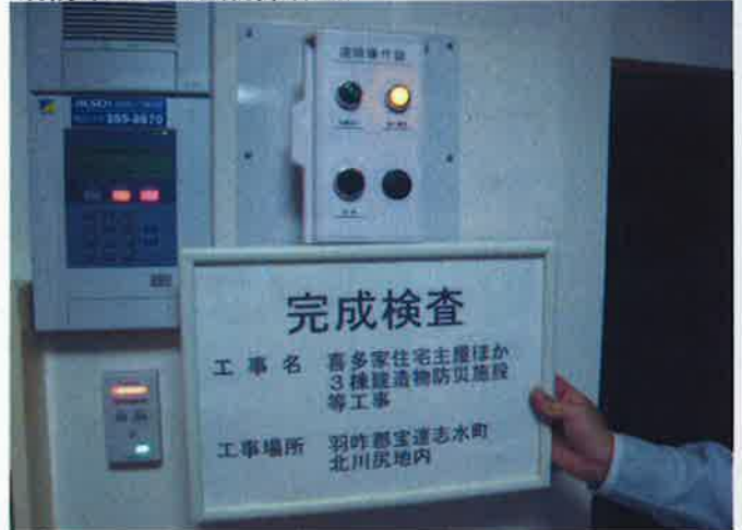
消防ポンプ 遠隔操作盤
