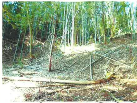
写真18 崩壊地上部の斜面状況
