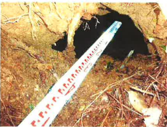
写真22 陥没した穴の状況。箱尺は3m程度入る。
