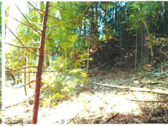
写真19 崩壊地上部の斜面状況
