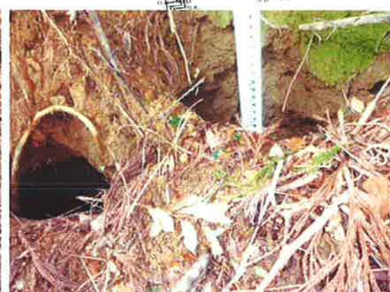
写真24 陥没した穴の状況
