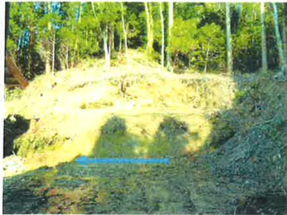
写真1 崩壊斜面全景
