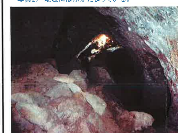
写真29 崩落し半分程度埋まっている。
