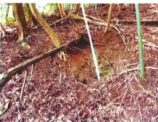
写真23 陥没した穴の状況
