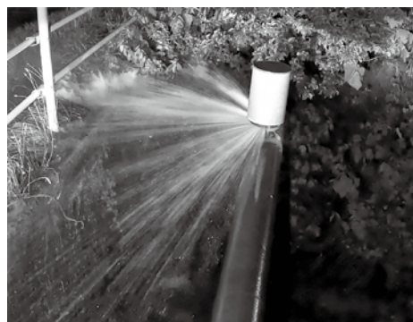
▲漏水状況(橋梁添架管)
